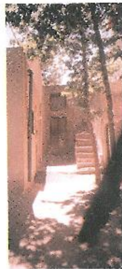
عکس شماره ۴ - تصویر یک منزل مسکونی به شدت فرسوده با ورودی چوبی و پله‌های منزل مسکونی فرسوده مجاور آن در حسن آباد زرگنده منطقه ۳ تهران
