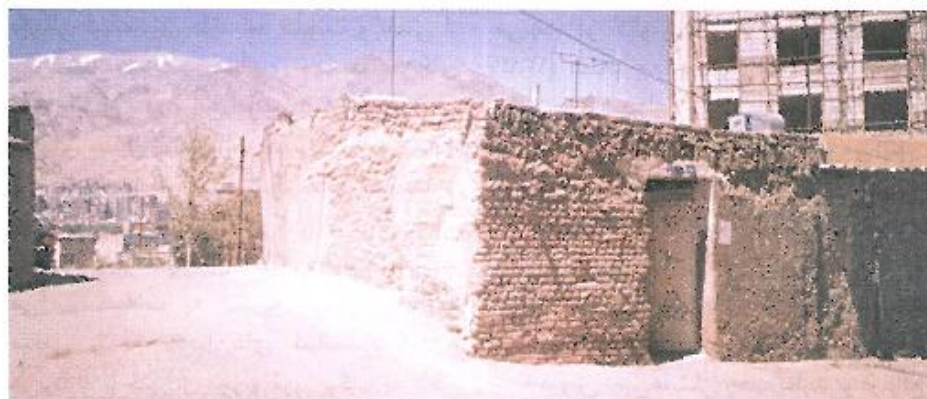
عکس شماره یک- یک منزل مسکونی فرسوده در کنار یک ساختمان ۵ طبقه در حال احداث محله قیطریه واقع در منطقه ۳ شهرداری تهران ( در حال استفاده بودن منزل فرسوده از کولر آن مشخص است)
