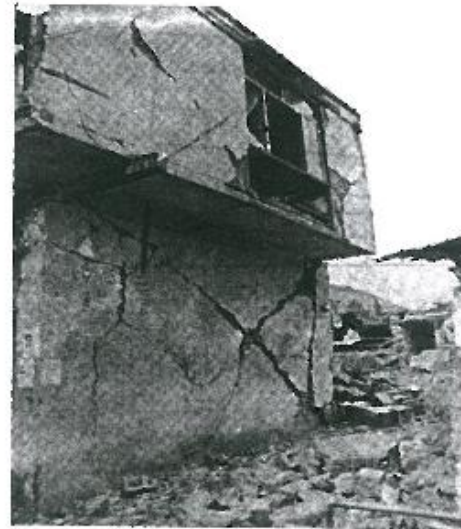
شکل ۳ - ترک‌های اریب دیوارهای برشی
