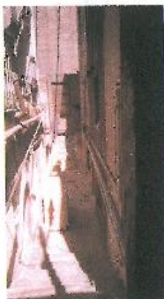
عکس شماره ۸- دالان تنگ، دربهای چوبی و یخچال کنار کوچه (در حال بهره برداری). محصوریت بالا، لوله کشی ها و کانالهای کولر در حسن آباد زرگنده منطقه ۳ شهرداری تهران
